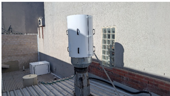
Kitchen exhaust fan 1
