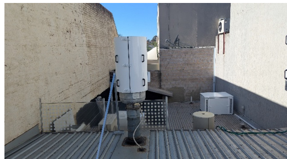
Kitchen exhaust fan 2
